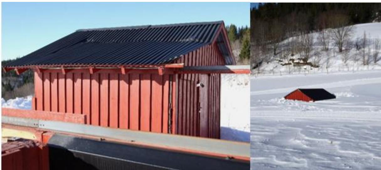
Figur 13: Slik så det ut etter stormen 11. mars 2021. Taket til foto-observatoriet lå ca. 30 meter ute på jorden mot Liaåsen etter å ha smadret det visuelle observatoriet i mellomlandingen.
